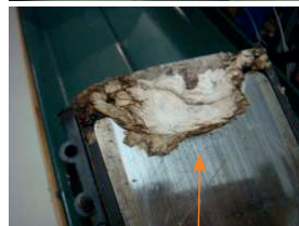
Acumulación de papel en el interior de la válvula
